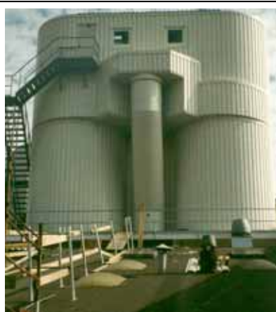
Двойной модуль бойлера, работающего на углевом топливе
